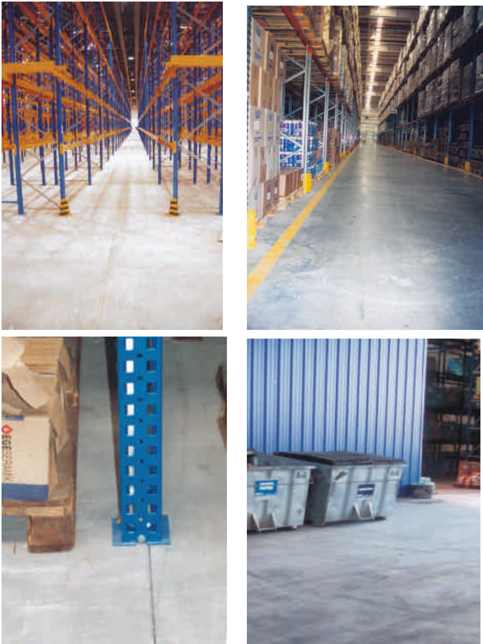
Abb.6 Punktlasten aus Regalfüßen und Containern
